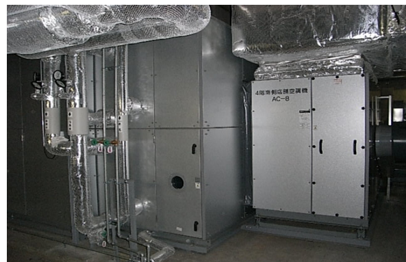
設備更新により導入した省エネ型空調機器(亀戸店)
